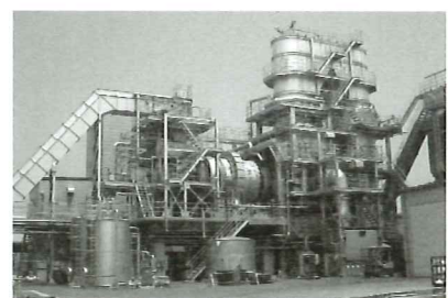
▲県下最大級の大型焼却炉
